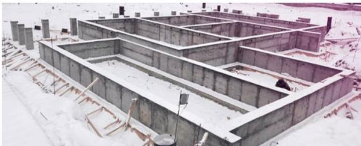
Рисунок 3 — Схема воздействия морозного пучения на фундамент и пример монтажа фундамента с защитой от морозного пучения. Обеспечение надёжности и экономической эффективности.
